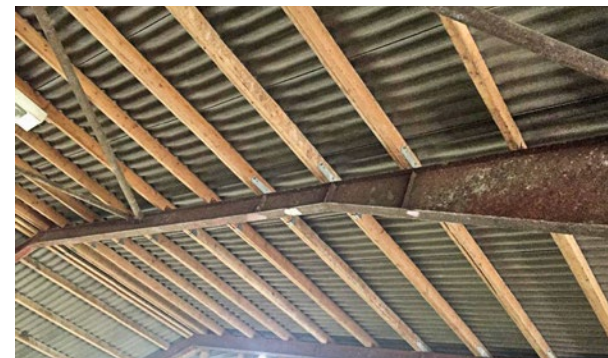
Figur 13 Bygning med vindgitter i andet fag. Der er udført kipningsfastholdelser, hvor der er indsat kropplader og anvendt bredere åse. Den mellemste fastholdelse er formentlig overflødig, da kroppladen er indsat pga. vinkelændringen i inderflangen. Der er ingen tryk-/trækstænger, så vindlasten på gavlen skal overføres af tagåsene.
