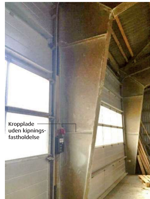
Figur 19 Rammeben mellem to porte. Kroppladerne viser, at der skal være kipningsfastholdelse, men det er ikke muligt at etablere på dette sted.
