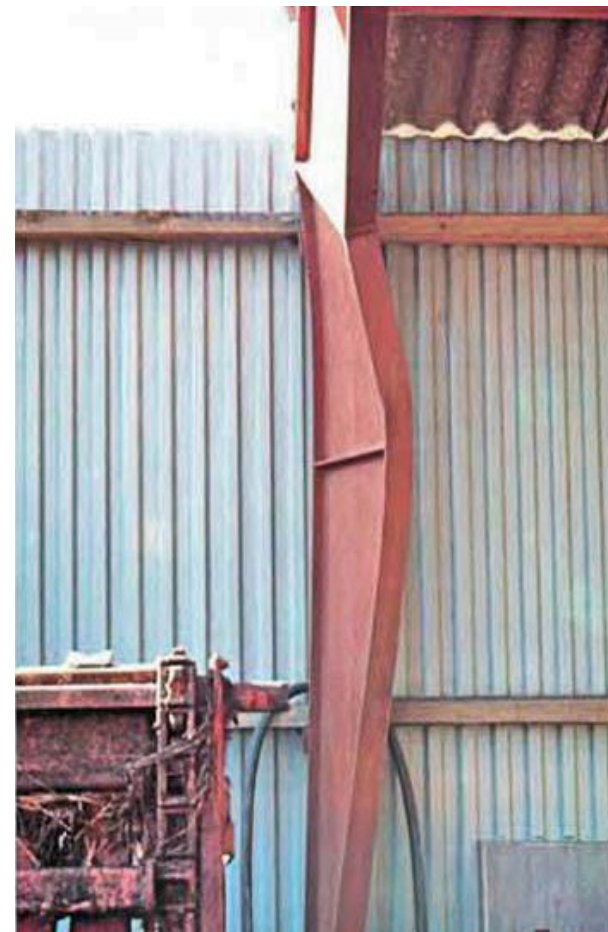
Figur 16 Kollapset rammeben, hvor kipningsfastholdelse ved kroppladen mangler.
